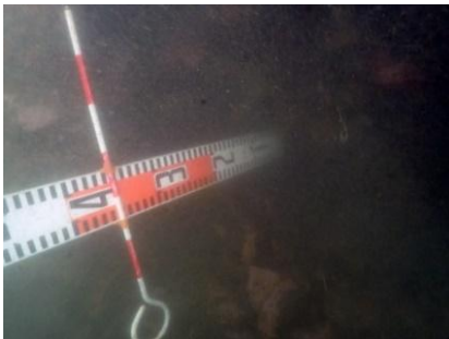
本体工 (水中部) の欠損
