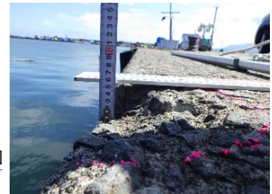
上部工の欠損
