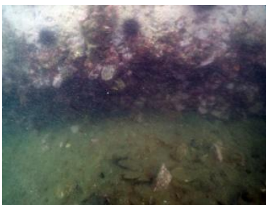
本体工 (水中部) の欠損
