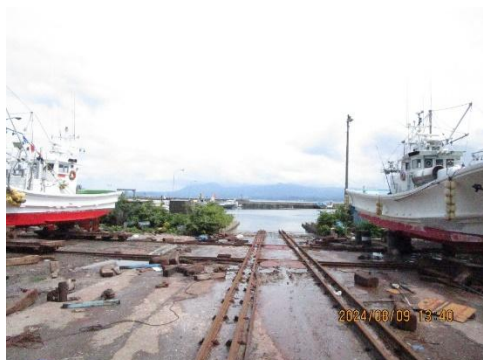
レールの老朽化
